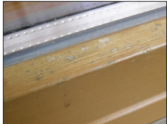
Fig. 3.1 : Dégâts causés par la grêle sur la fenêtre
